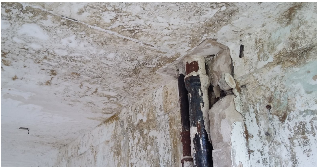
Poškodenie dlhodobým zatekaním okolo strešných zvodov – skorodované výstuže stropných dosiek
