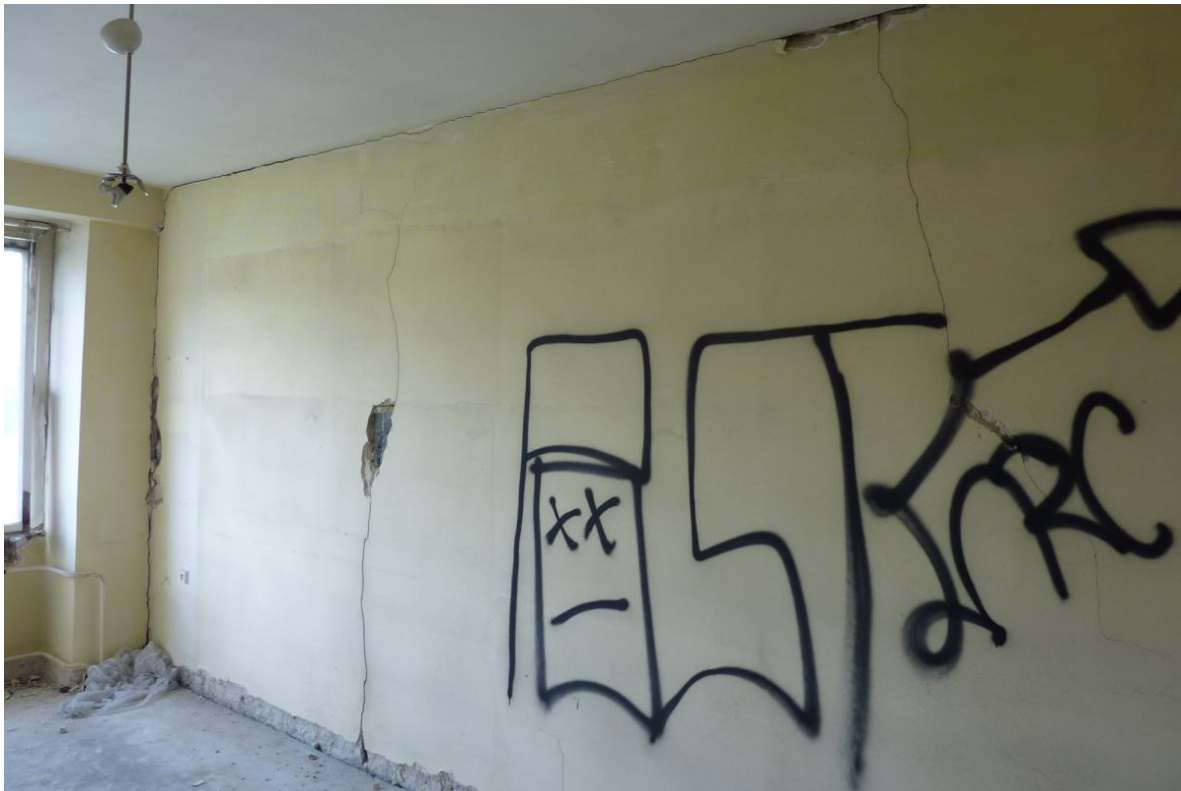
Trhliny v stene - osadená na okraji stropnej dosky v dilatácii (dôsledok priehybu dosky)
