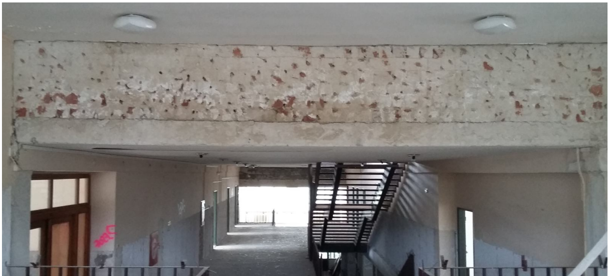
Priehyb od nadmerného pritaženia okraja stropnej dosky – krčok (dil. celok 3)
