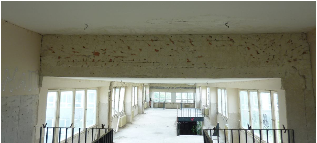
Priehyb od nadmerného pritaženia okraja stropnej dosky – krčok (dil. celok 4)
