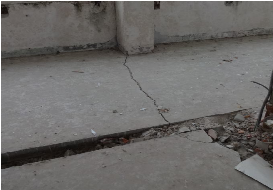
Trhlina v podlahe
