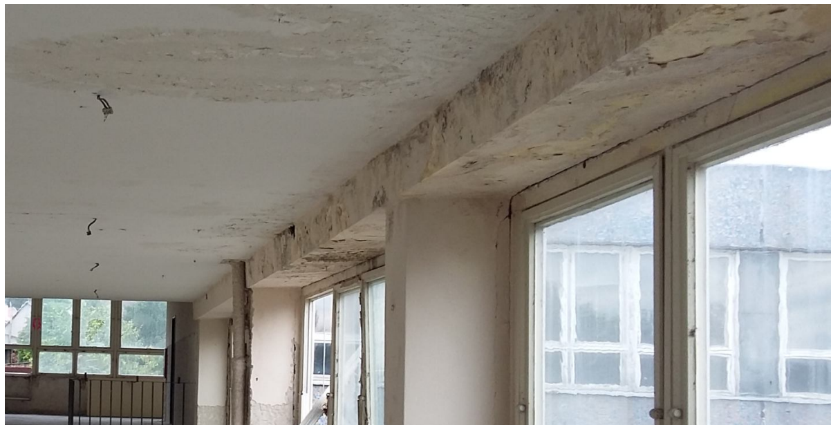
Poškodenie zatekaním cez strešnú izoláciu – skorodovaná výstuž priečlí
