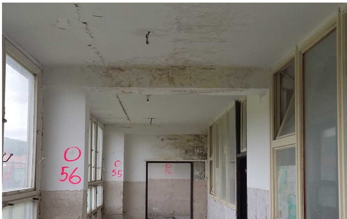
Poškodenia zatekaním cez strešnú izoláciu - skorodovaná výstuž priečlí
