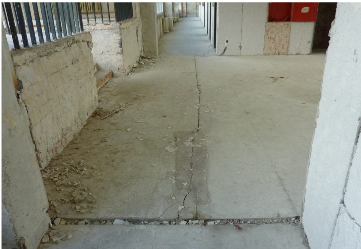
Trhlina v styku panelov – dôsledok nadmerného priehybu okraja dosky (viď predošlé obrázky)
