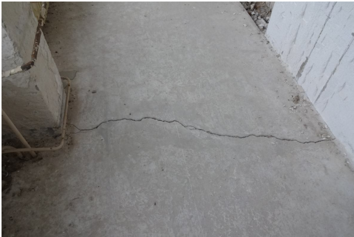
Trhlina v podlahe
