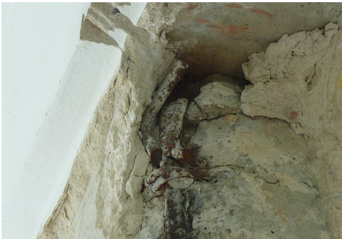
Detail styku stĺp – priečľa, rozdrvená styčná plocha, neodborné kotvenie
