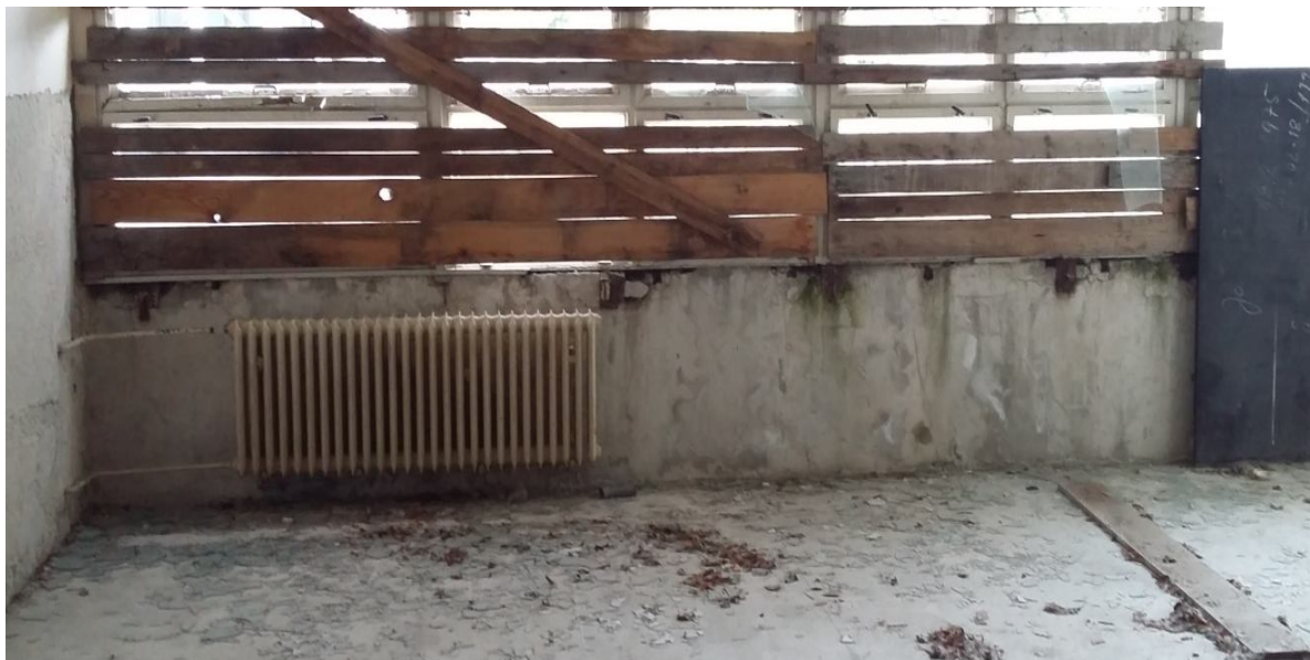
Poškodenia zatekaním cez rozbité okno
