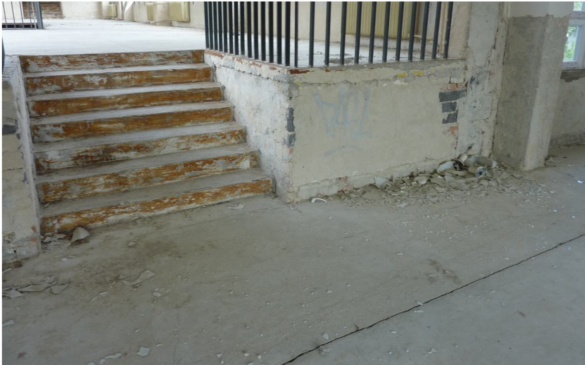
Trhlina v styku panelov – dôsledok nadmerného priehybu okraja dosky (viď predošlé obrázky)
