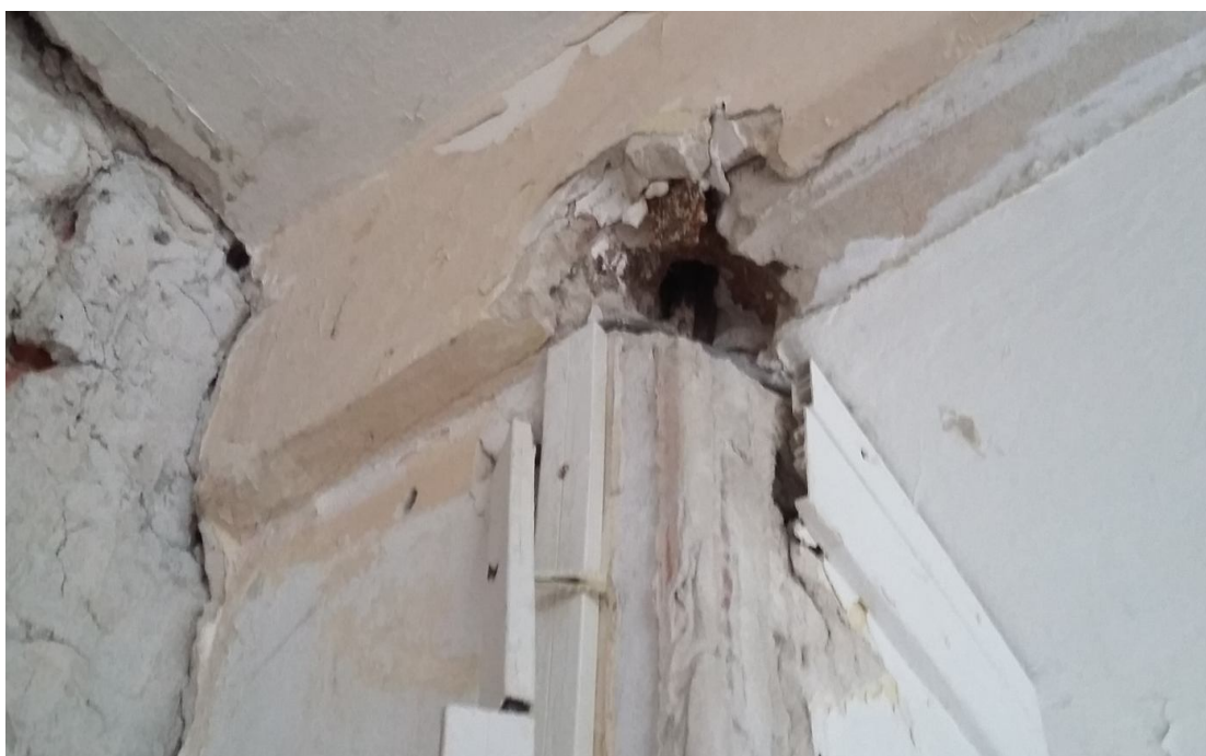
Detail styku stĺp – priečľa, kotevná výstuž je bez betónovej zálievky
