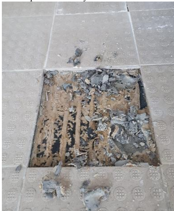
Obr. 1: podložie bez hydroizolácie
